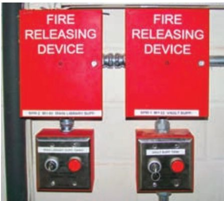
Stationen zur manuellen Freigabe des Tresorraums und der Bibliothek befinden sich im Maschinenraum.
